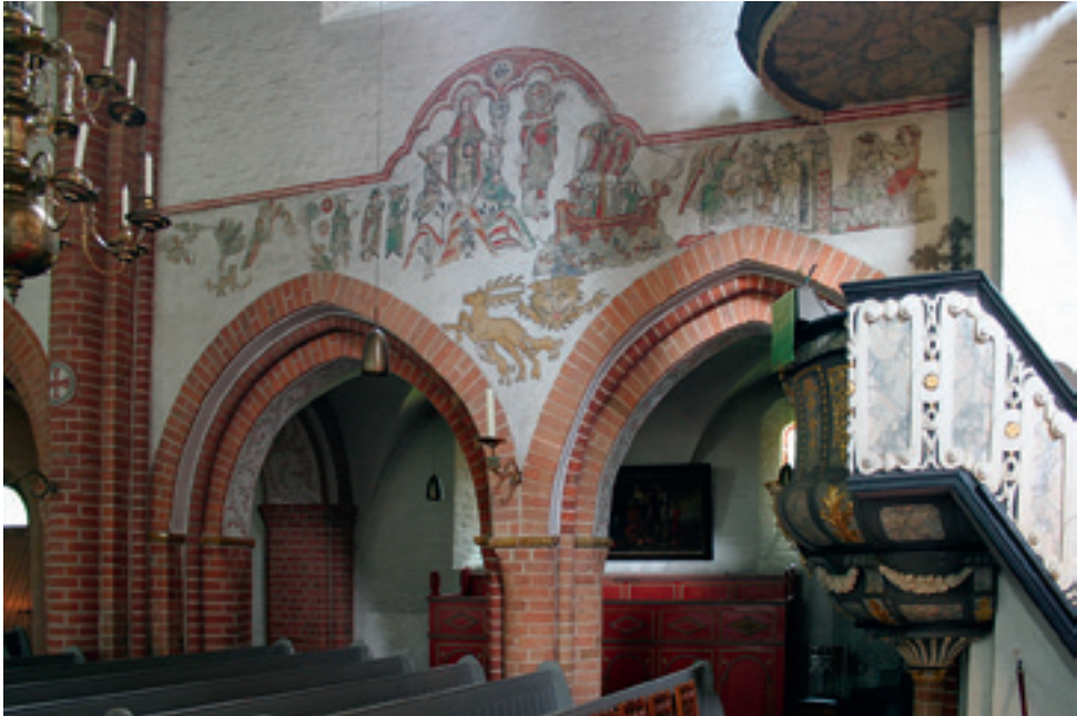
4 Mölln, Fresken der Nordwand, gesamt; Zustand 10/2008
